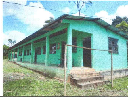
Foto 2: Se observa el deterioro de la pintura exterior de la escuela.
