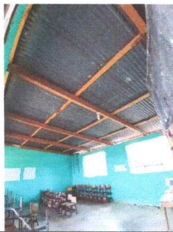
Foto 3: Se observa en el interior de una de las aulas el deterioro de las vigas y costaneras.
