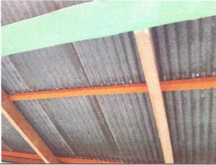
Foto 1: Se observa el deterioro de las láminas ( perforaciones y óxido)
