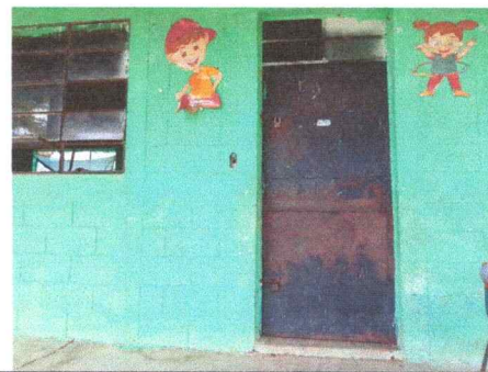
Foto 4: Se observa el mal estado de la puerta se haran correcciones, lijado y pintura (3 aulas y Direccion)
